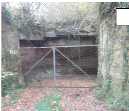
Barrière sécurisant l'accès à la carrière souterraine.
